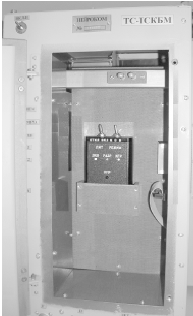
Рисунок 2.31 - Установка прибора ТЛ-ТСКБМ в экранированный отсек блока ТС-ТСКБМ
